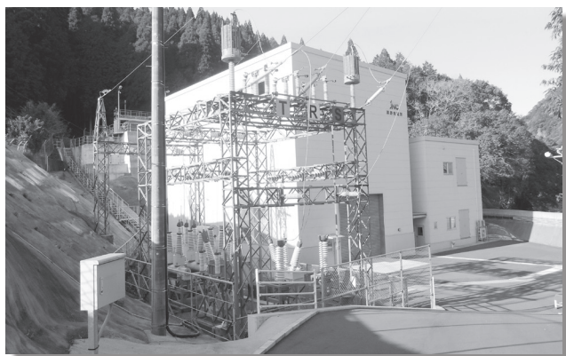
JNC(株) 栗野発電所
